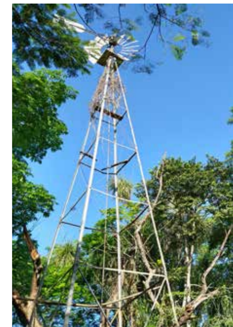
La tour et la girouette d'une pompe éolienne encore en activité.
